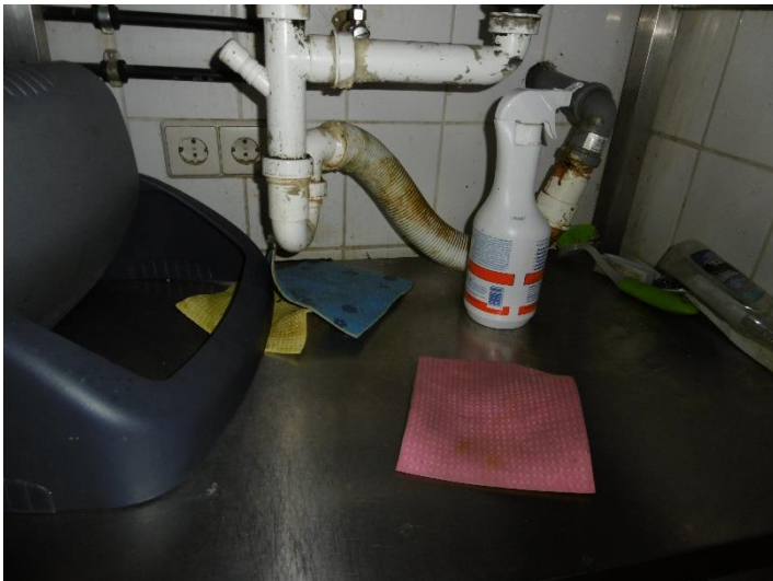
Der Siphon unterhalb des Waschbeckens wies starke Verunreinigungen auf.
